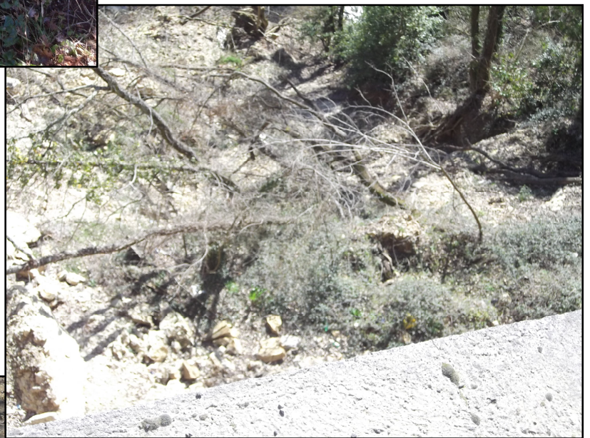
Figura _____ Foto porzione in dissesto
